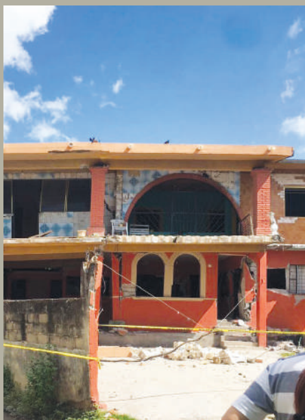
Zona de Ixtaltepec, Oaxaca después de los sismos de 2017 Fotografías: Mejoremos
