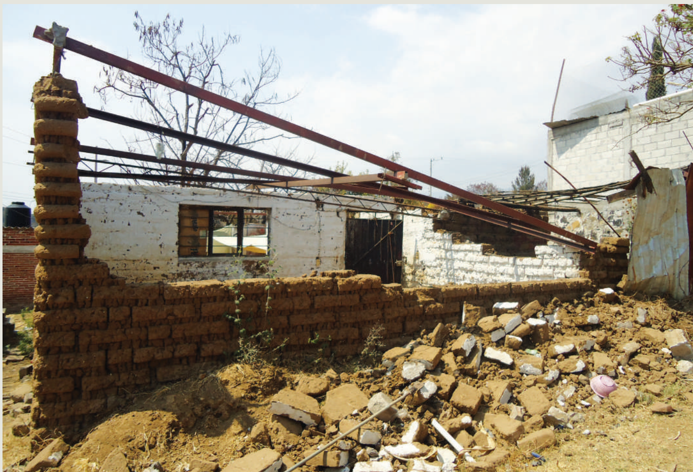
Vivienda de adobe destruida tras los sismos de septiembre de 2017, Totolapan, Morelos Fotografía: Casa y Ciudad
