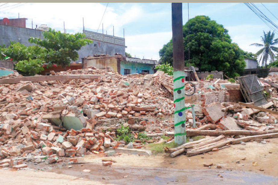
Inmueble destruido en Juchitán, Oaxaca, septiembre de 2017 Fotografía: Copevi
