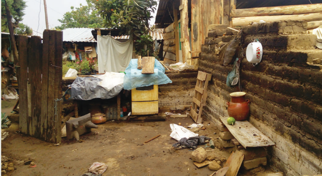
Vivienda de adobe destruida tras los sismos de septiembre de 2017, Hueyapan, Morelos Fotografía: Casa y Ciudad
