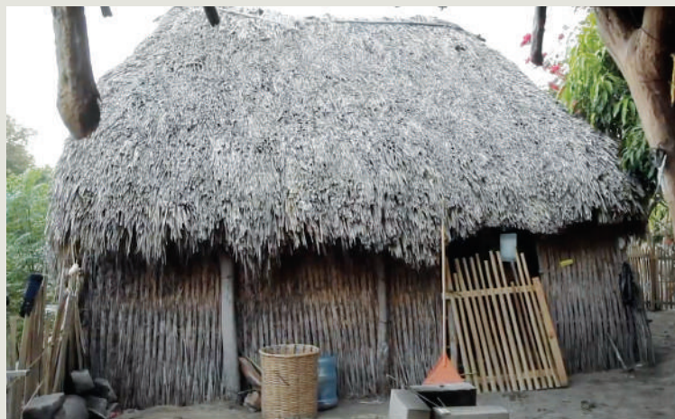
Vivienda tradicional dañada, San Mateo del Mar, Oaxaca, después de los sismos de septiembre de 2017 Fotografías: Río
