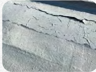
PINTURA DESCASCARADA Y GRIETAS
