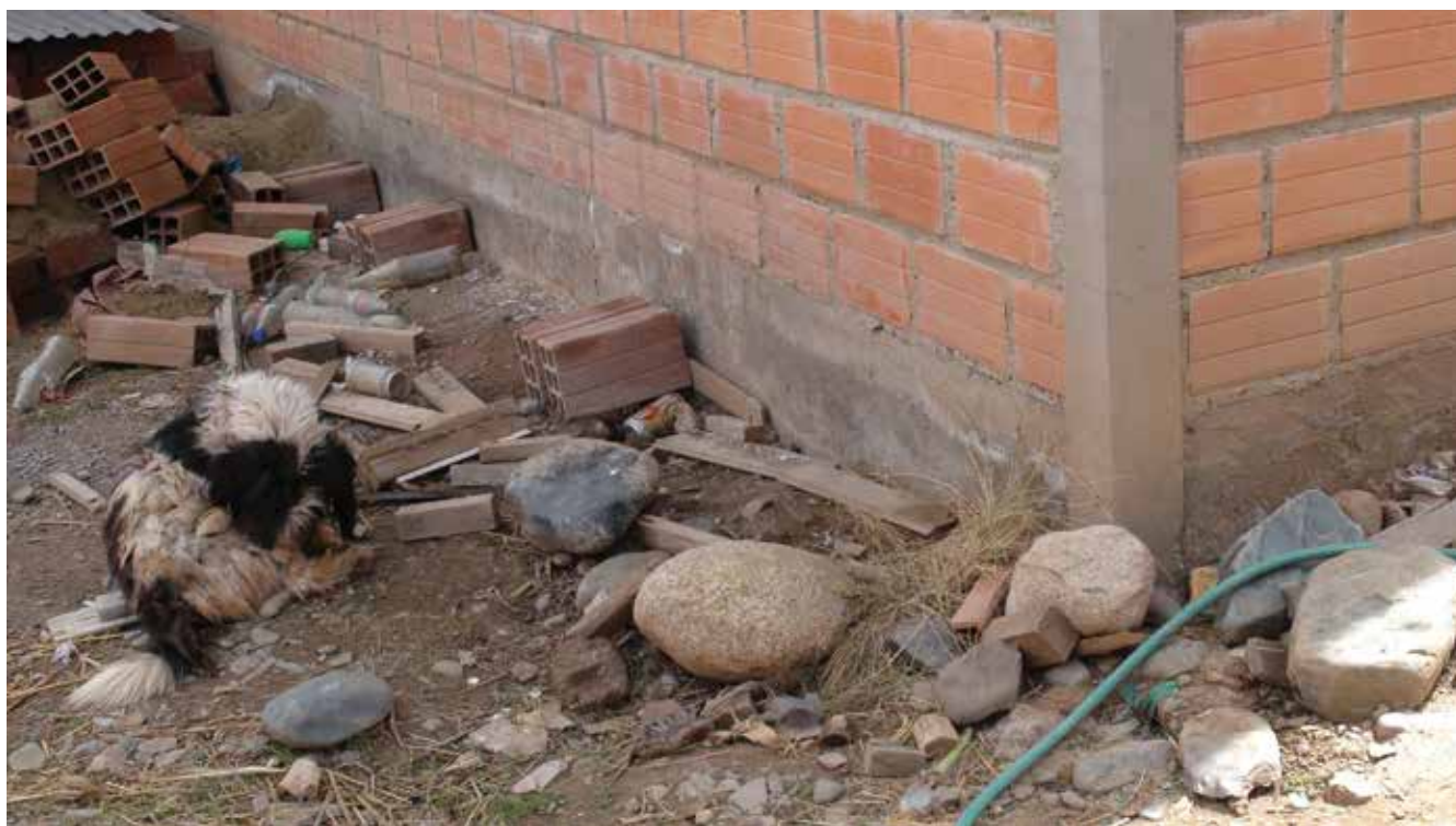
Ilustración 3.- Falta de impermeabilización del sobre cimienta causa del deterioro de los muros.
