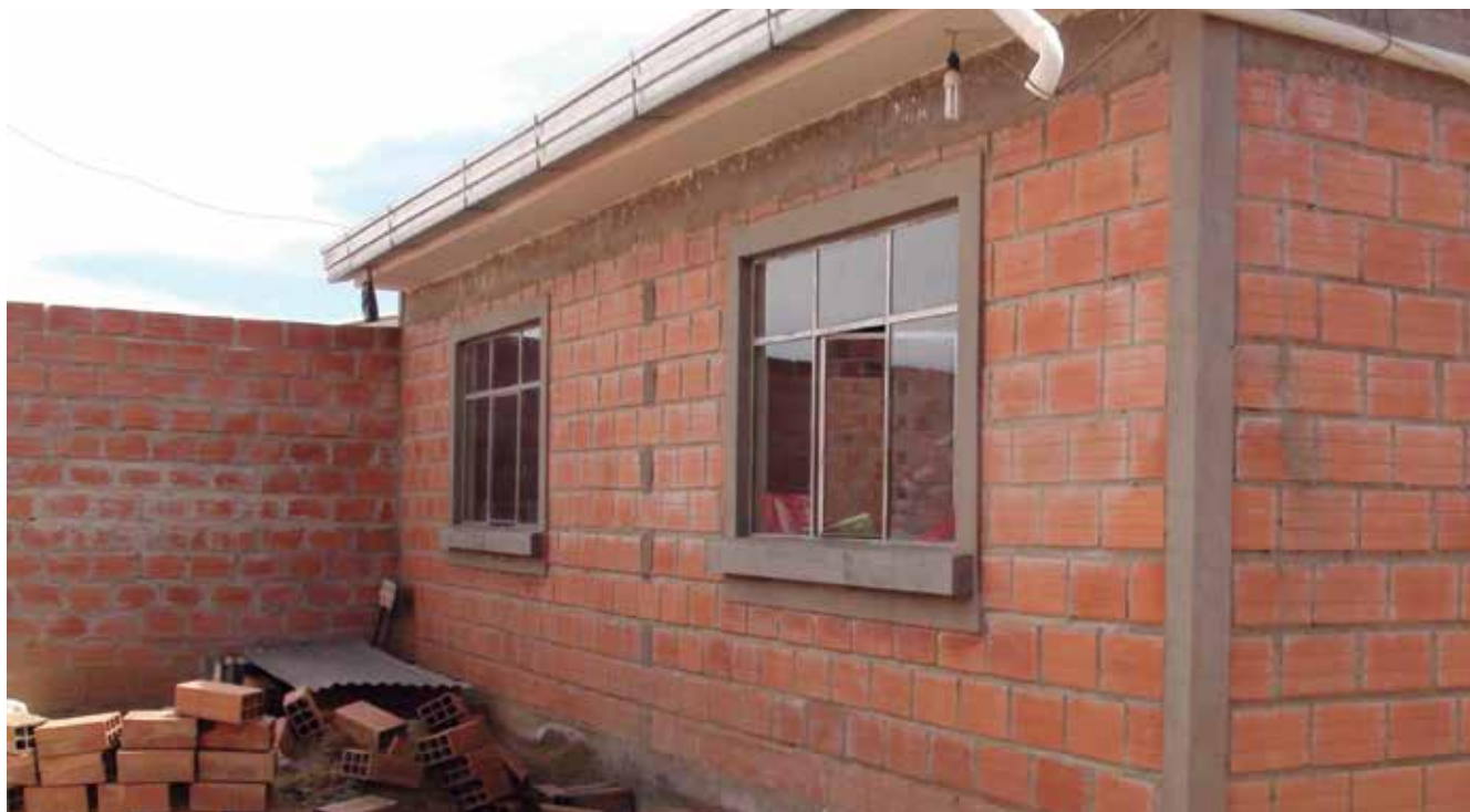
Ilustración 1.- Falta drenaje pluvial
