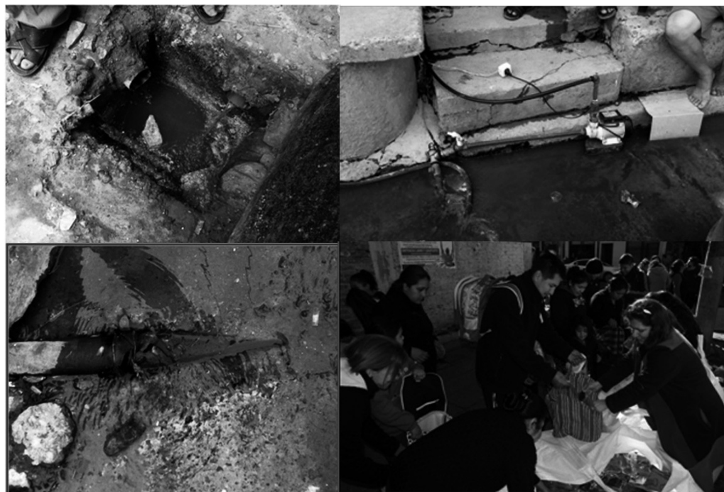
Figura 1.- Manguera de agua pinchada atravesando una precaria cámara cloacal (Ciudad Oculta Mz 32). Figura 2.- Manguera de agua pinchada utilizada para abastecer a 25 familias conectada a un motor e inmersa en líquido cloacal en Santo Domingo y calle s/n (La Loma-Villa 21-24). Figura 3.- Manguera de agua pinchada sobre terreno utilizada para abastecer a 100 familias en Santo Domingo y la calle s/n (La Loma-Villa 21-24). Figura 4.- Voluntarias de los Comedores Comunitarios entregan agua potable en sachets que provee la empresa prestadora AySA en Chilavert y Pola (Villa 20)
