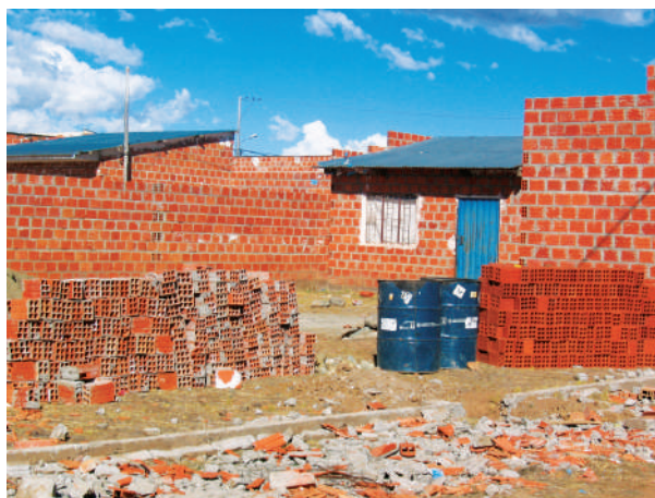
(Foto archivo propio) Distrito 8, Zona Parcopata I, se observan turriles de almacenamiento de agua.
