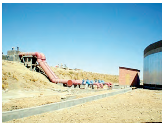
Fotografía: Archivo Red Hábitat Sistema de bombas a la laguna anaeróbica
