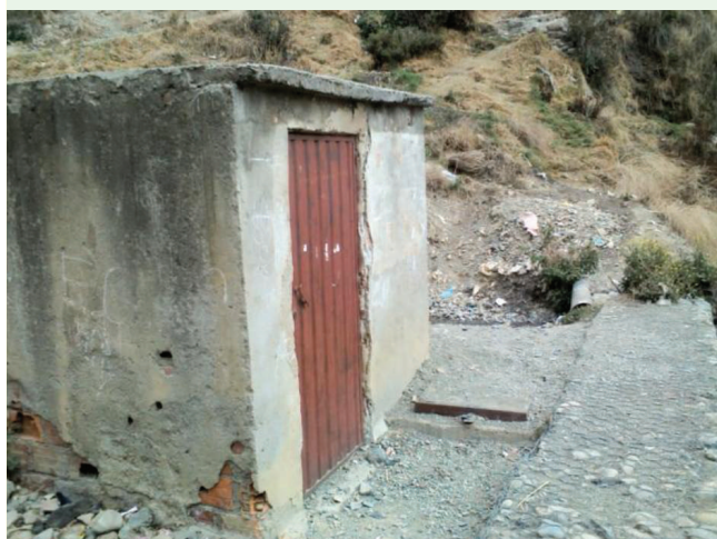
Caseta de hipocloración Cooperativa DamarChua
