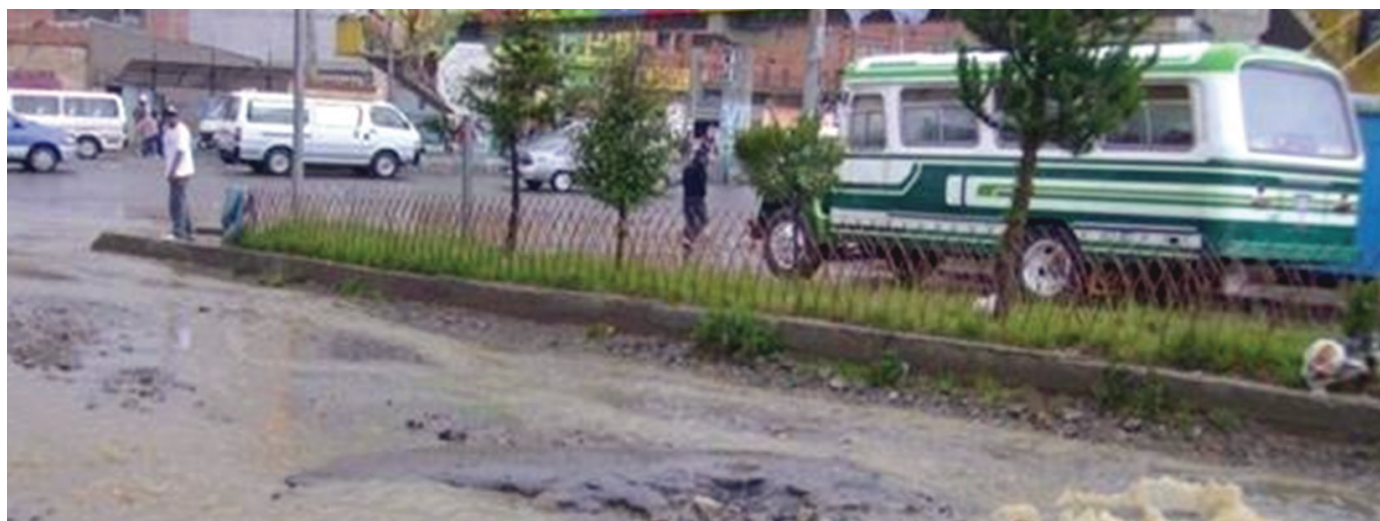
Taponamientos con escombros y material granular del alcantarillado sanitario (Archivo fotográfico RED HÁBITAT).
