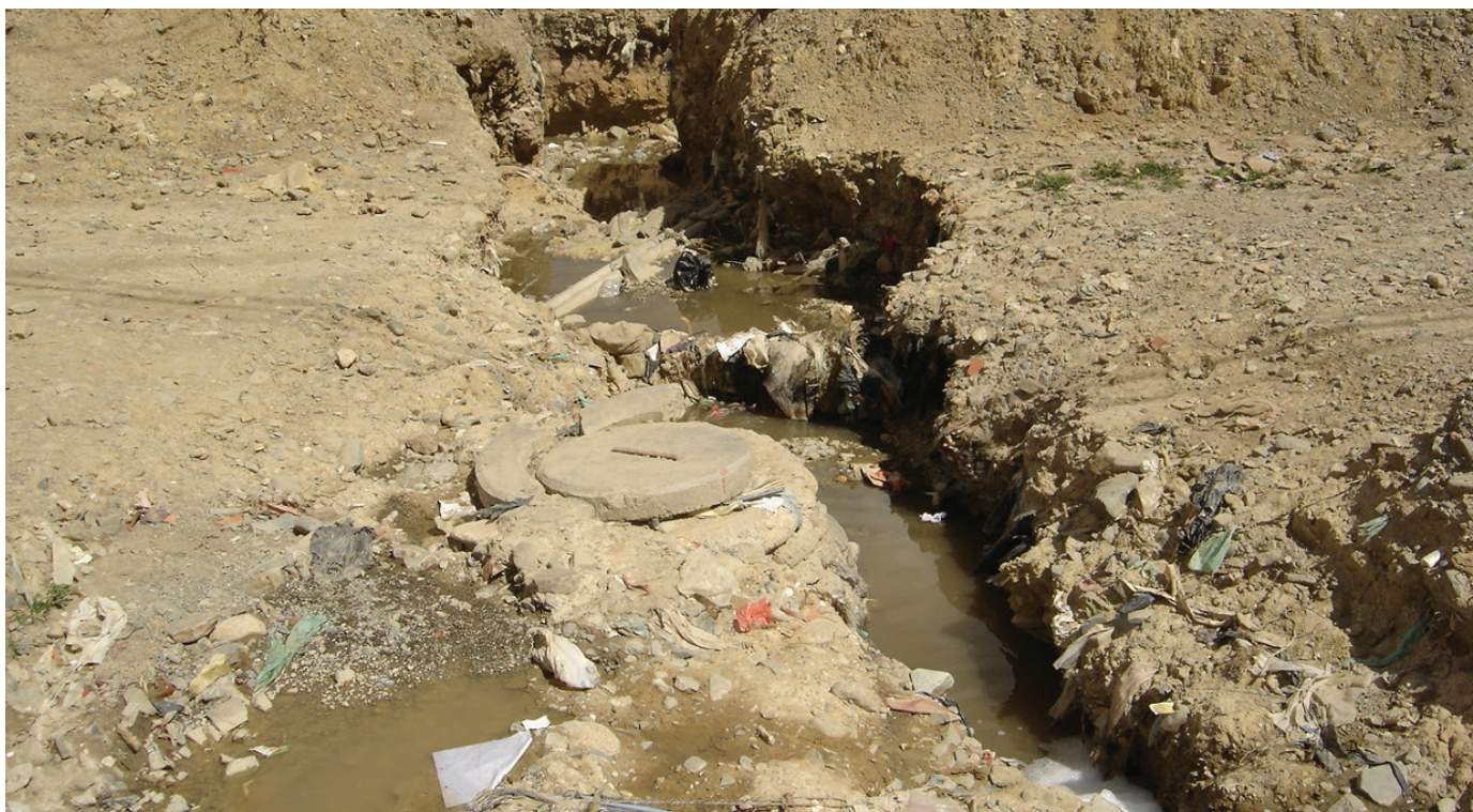
Colapso, rotura y ausencia de mantenimiento del sistema de alcantarillado sanitario (Archivo fotográfico RED HÁBITAT)
