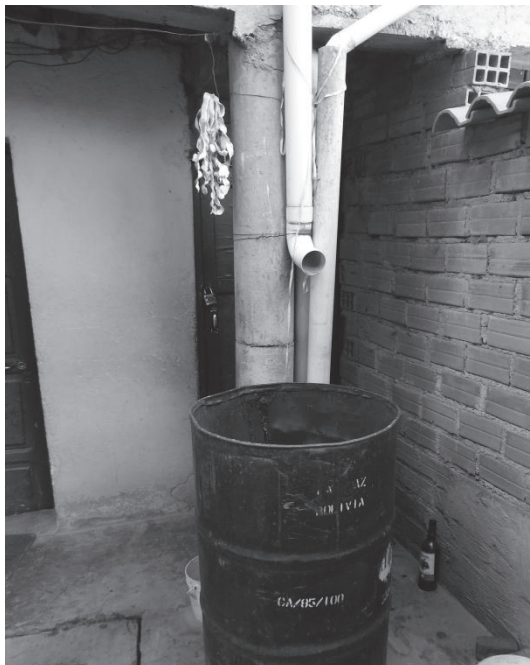
Ductos que conectan a los turriles de los techos.
